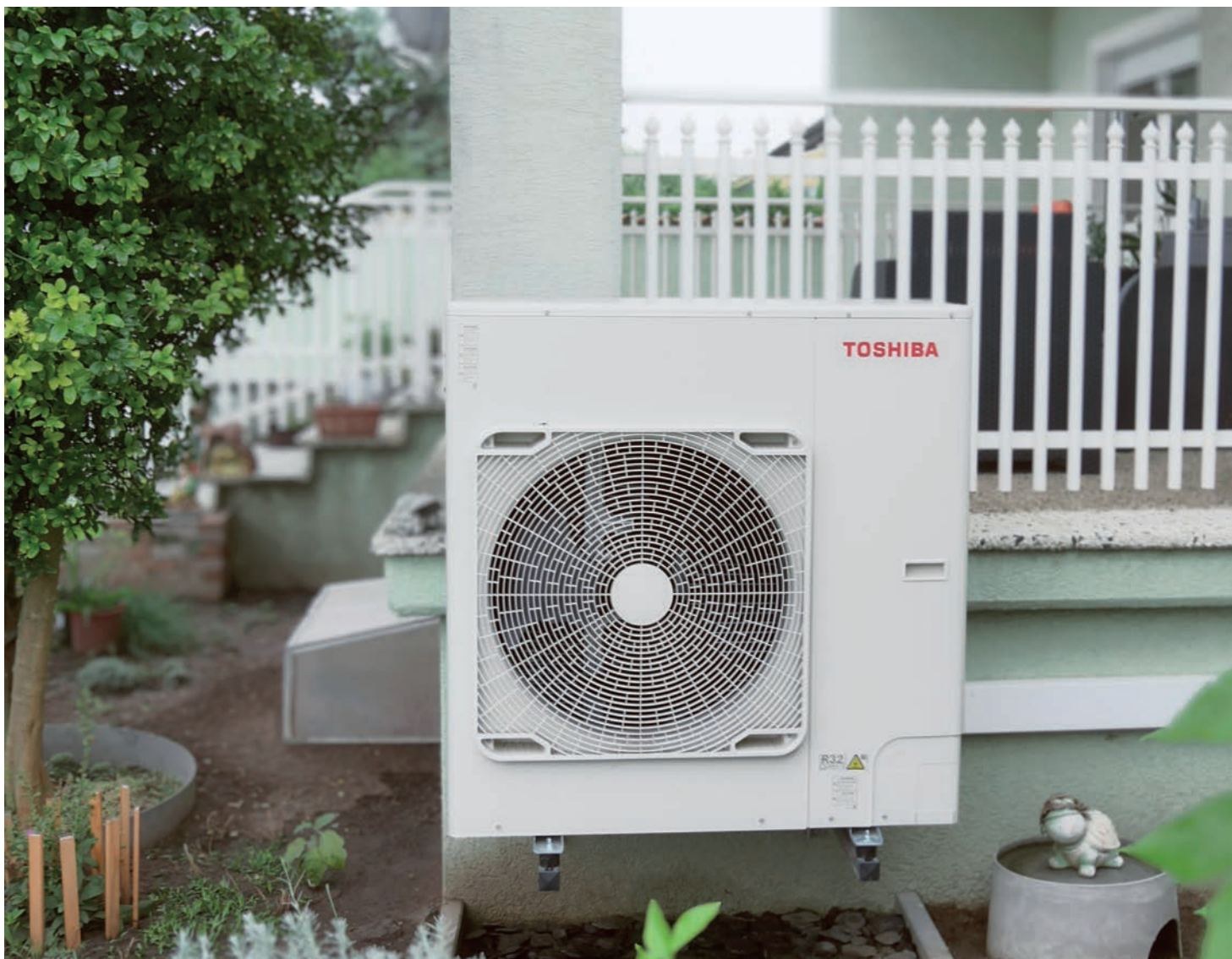
Rodinný dom v Podersdorf, Robert Müllner GmbH - Kälte Klima Installateur
